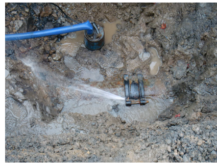
漏水事故の発生
