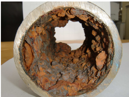
老朽管の内面状況
