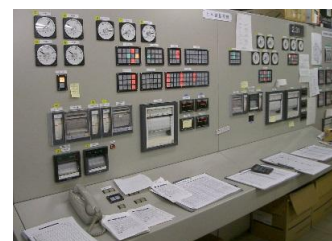
浄水場監視盤
